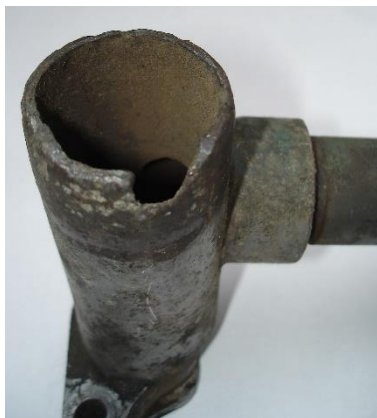
Schadhaftes Wasserrohr am B-Motor
